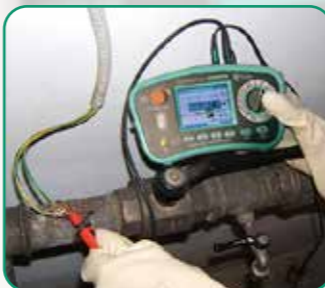
Continuity check of equipotential bonding
